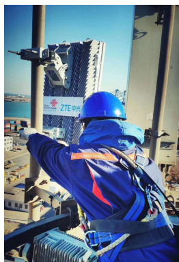
▲ 天津港 5G 基站实施现场
